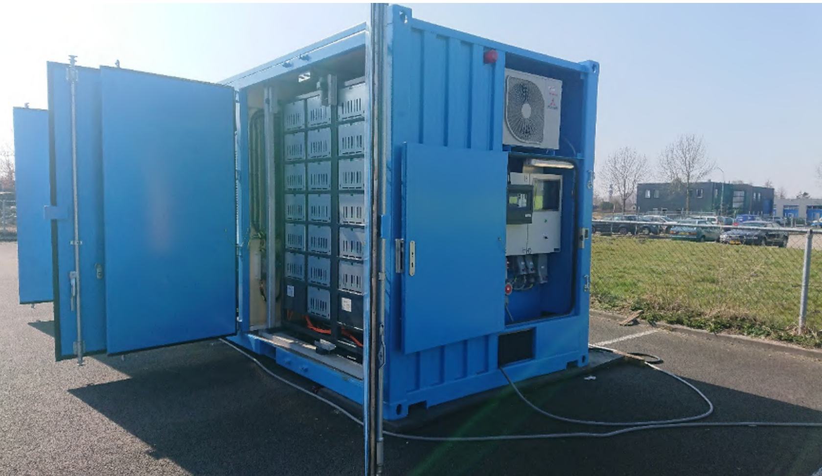
⚡ Buitenzijde en binnenzijde E-CO2tainer Foto's: Eekels Technology.
