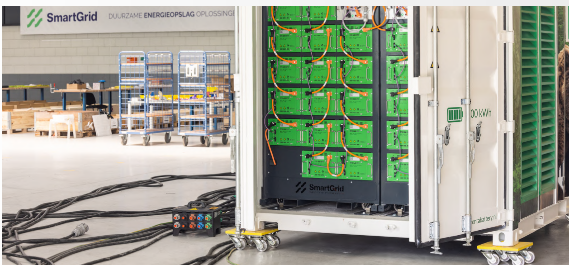
Batterijcontainer van SmartGrid
