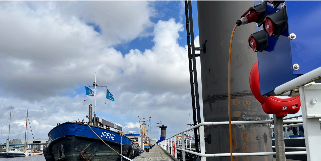
Seijsener Walstroomkast Groningen Seaports
