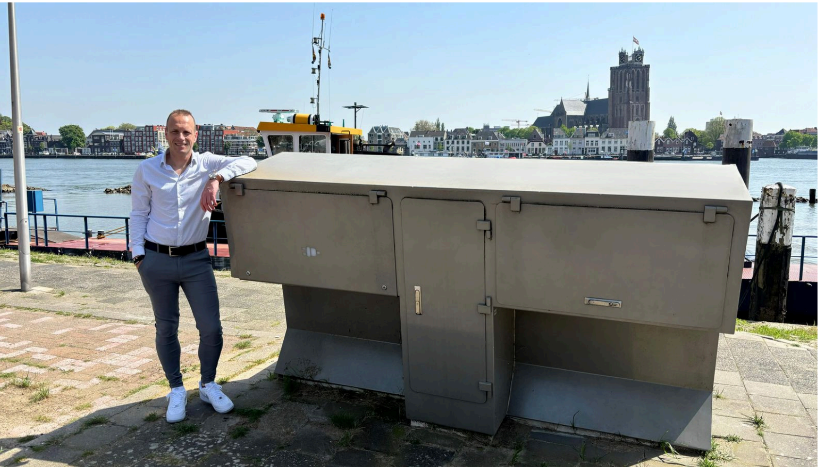
🔌 Arjan van Die bij een "walstroombank", een walstroomkast met aan de voorzijde een bankje met uitzicht op het water en op de achtergrond de stad Dordrecht. Op de foto onder is het zitgedeelte van het bankje zichtbaar.
